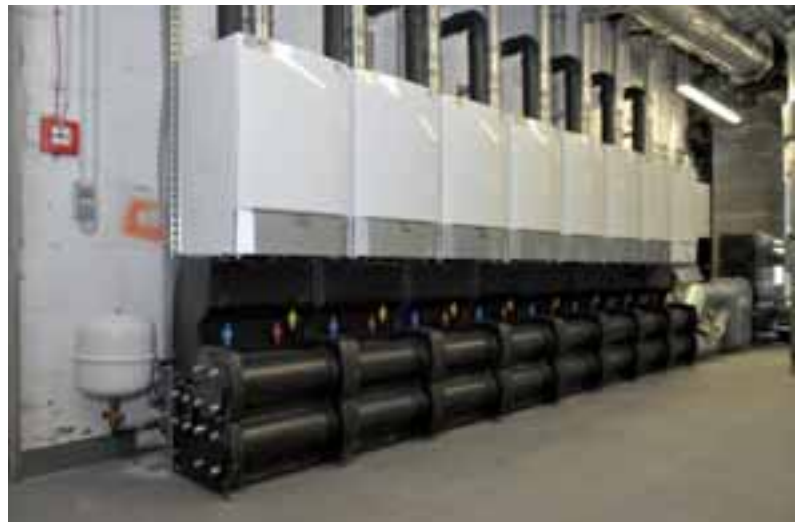
Die Leistungsbandbreite von acht in Kaskade geschalteten Quinta Pro Gas-Brennwertgeräten ist enorm. Die Nordhorner Anlage moduliert mit einer Nennheizleistung im Bereich von 20,5 bis 920 kW. Fotos: Remeha GmbH, Emsdetten
