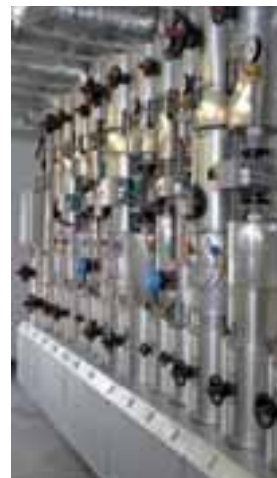
Die vorbildliche Montage ist wesentlich: eine übersichtliche und effiziente Heizkreisverteilung im delfinoh Nordhorn.
