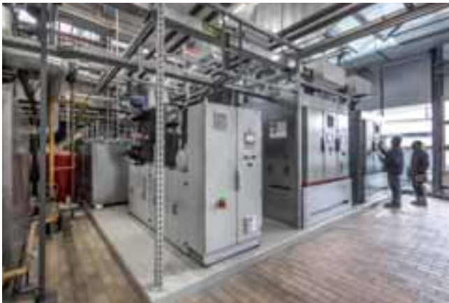
Die Einsatzzeiten der einzelnen Aggregate und die Bewirtschaftung des Wärmespeichers werden durch eine übergeordnete Regelungsstrategie festgelegt. Grundlagen der täglich neu zu erstellenden Fahrpläne sind unter anderem die Witterungsdaten und das spezifische Nutzerverhalten.
